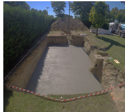
3. Platea in calcestruzzo armato per stabilizzare il terreno su cui poserà la struttura
